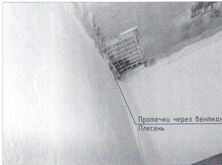
Фото №11. Фрагмент вентиляции
