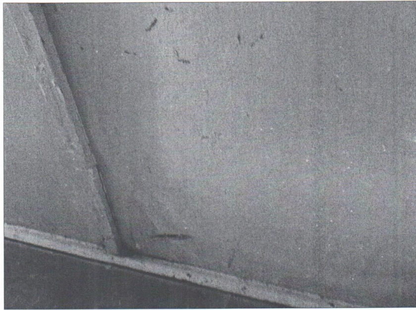
Фото №19. Фрагмент отделки стен (разрушение отделки)
