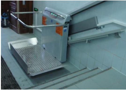
Положение платформы на нижней площадке
