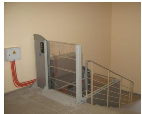
Верхняя площадка платформы вертикального перемещения
