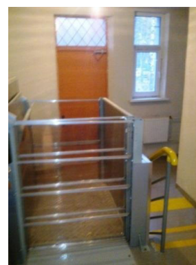
Подъемник в приквартирном тамбуре
